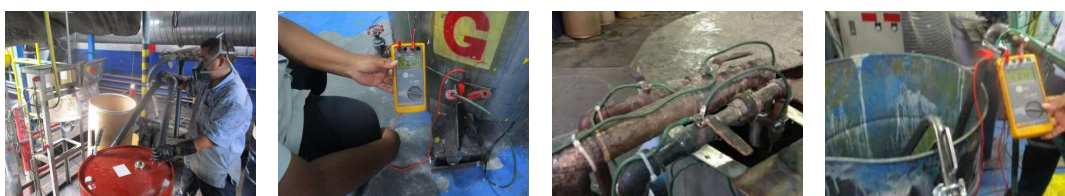
การปรับปรุงระบบ Grounding-Bonding และตรวจสอบความพร้อมใช้งาน เพื่อป้องกันการเกิดความเสี่ยงด้านอัคคีภัย
